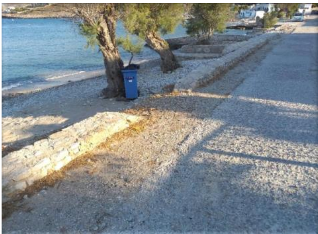
Εικόνα 11. Άποψη παραλιακού τμήματος, υποβαθμισμένη κατάσταση οδοστρώματος
