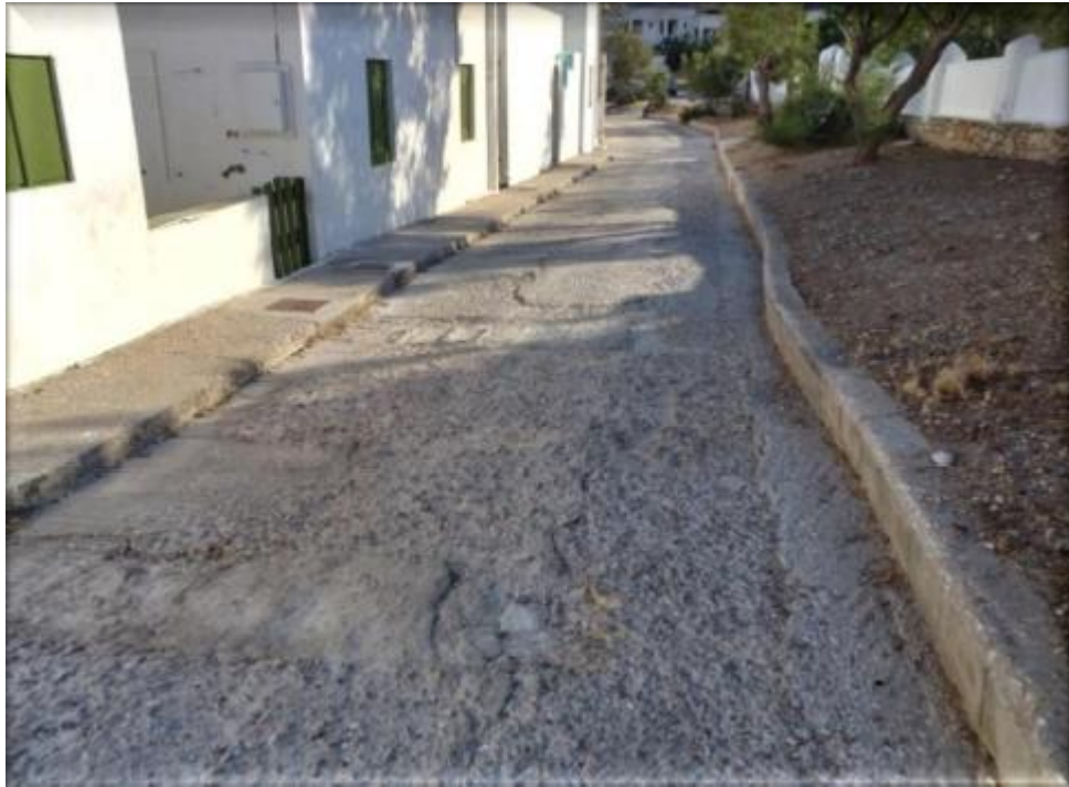
Εικόνα 5. Άποψη κατάστασης οδοστρώματος
