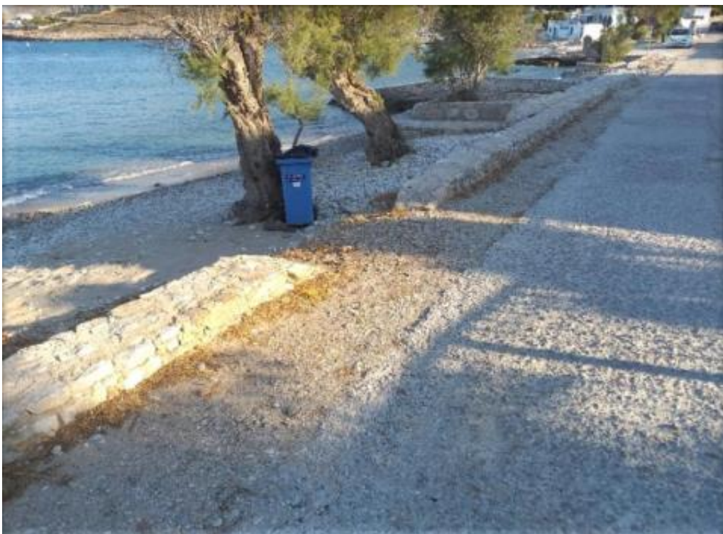
Εικόνα 8. Άποψη παραλιακού τμήματος, υποβαθμισμένη κατάσταση οδοστρώματος
